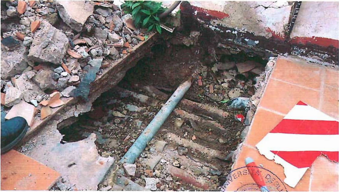
Infiltrazione terrazzo secondo piano Reggia
